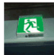
非常用誘導灯
